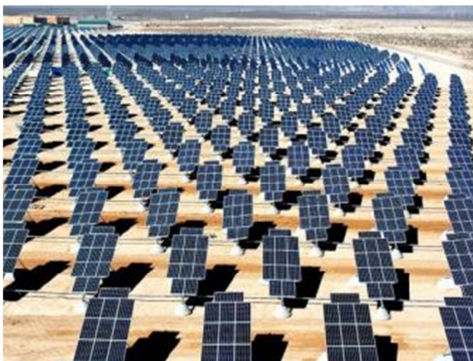
Slika 5: Fotovoltaična elektrarna Nellis Solar Power Plant, moči 14 MW (70.000 solarnih panelov) v puščavi Nevada, ZDA (6)
