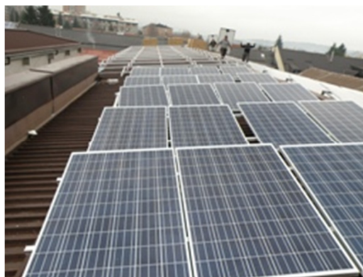
Slika 10: Fotonapetostni moduli nameščeni na ravni strehi (10)
