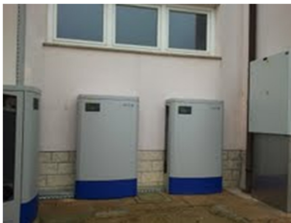
Slika 14: Razsmerniki za sončno elektrarno (9)
