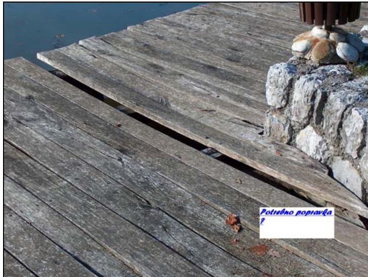
Fotografija 19: Potrebno popravila?
