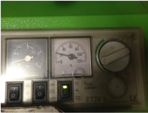
Slika 6: Merilec temperature na kotlu
