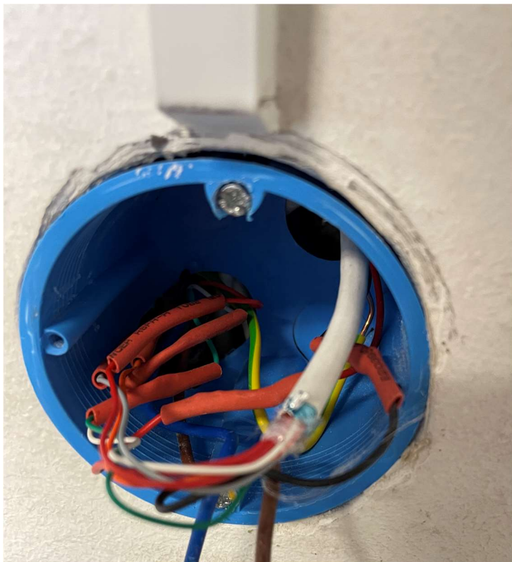
Slika 12: Izgled kablov ob končanem delu s spajanjem in krčenjem toplotne krčljive ovojnice (Vir: lasten) Ena učilnica je bila pripravljena na preizkus. Najprej smo krmilnik poskusno priklopili, da smo preverili, ali bralnik deluje tako, kot je treba.
