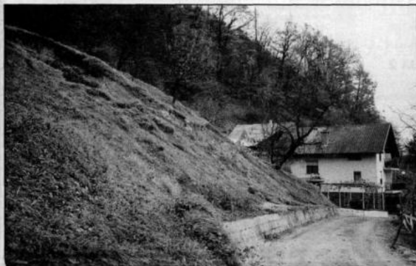
Največji plaz, ki bo terjal tudi največ sredstev za sanacijo, se je utrgal v Podkraju pod cerkvico Sv. Jakca. K sreči ne ogroža stanovanjskih hiš, če pa bo odnesel cesto, bo del prebivalcev odrezanih od sveta. Plaz so delno že sanirali, očistili pa so tudi cesto, ki je bila neprevozna.
