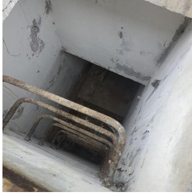
Slika 23: Bazen za odvodnjavanje podtalne vode (vir: avtorici naloge)
