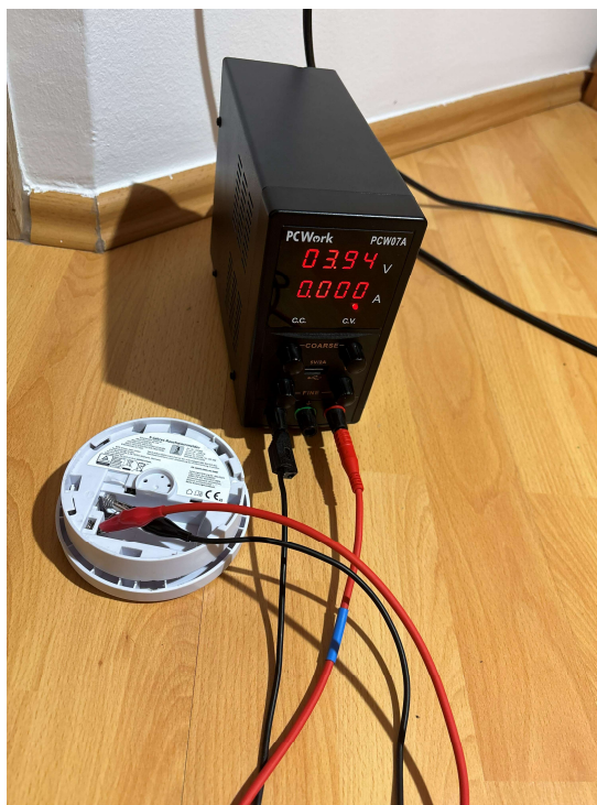
Slika 6: Pregled napajanja pri katerem se proži alarm javljalnika. (Lasten vir)
