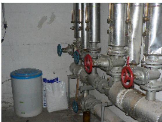
Slika 16: Toplotna postaja – ventili in cevi
